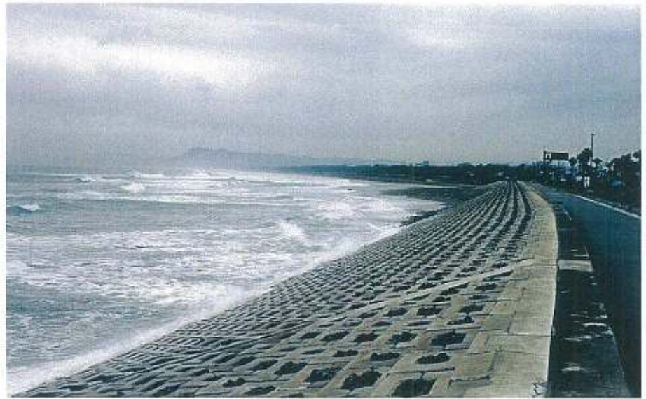
緩傾斜護岸 千葉県鴨川土木事務所 和田白浜海岸高潮対策工事 サーフブロック2TON型 3割勾配にて施工
